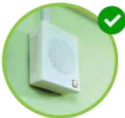
Аудиотрансляция в здании (при необходимости)
